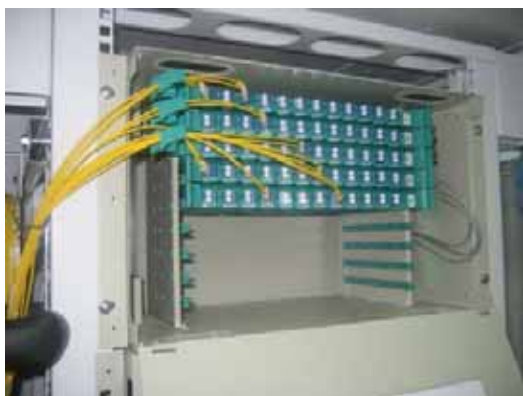
Εικόνα 22. Διασυνδέσεις σε καταναμητή εσωτερικού χώρου.
