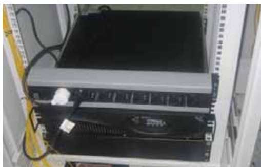
Εικόνα 24. Σύστημα αδιάλειπτης παροχής τάσης (UPS) κόμβου.
