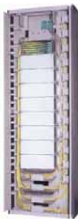
Εικόνα 20. Πλαίσιο οπτικού κατανεμητή, τύπου Rack (κατασκευάζονται σε κλειστό χώρο).
