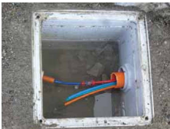
Εικόνα 10. Εσωτερικό φρεατίου πρόσβασης στην ιδιοκτησία, με εμφανές το πρόβλημα της στεγανότητας όχι μόνο του φρεατίου αλλά και των σωλήνων και των μικροσωλήνων.
