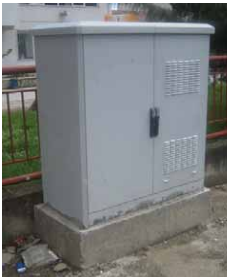
Εικόνα 26. Περίβλημα καταναμητή σε υπαίθριο χώρο.
